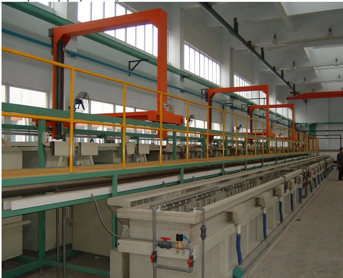
El zinc placas equipo. planta de galvanizado.
