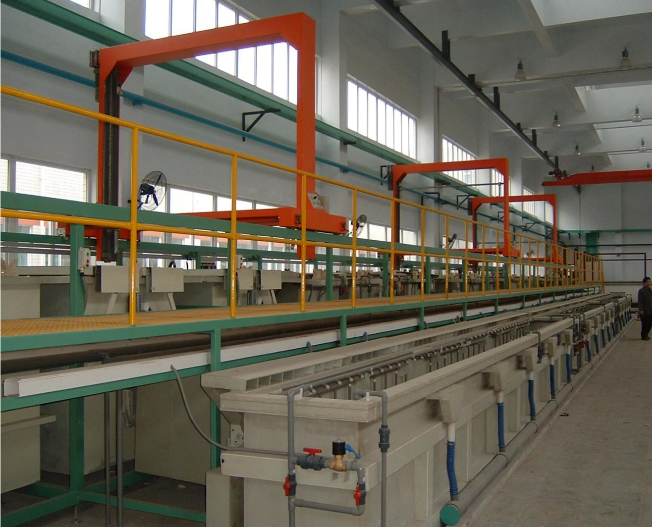
Galvaniz ekipman. Galvanizleme tesisi.
