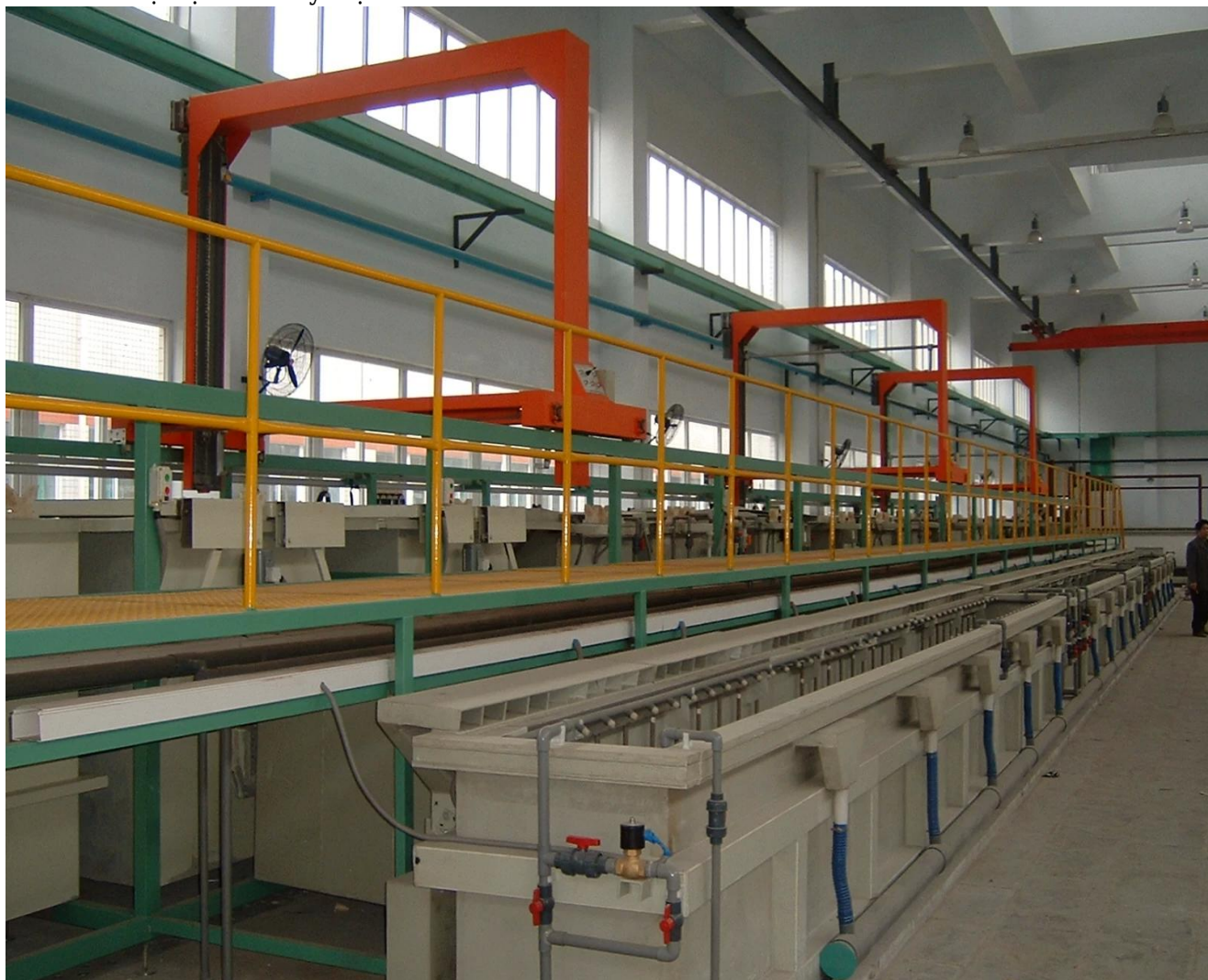
Kèm thiết bị mạ. nhà máy mạ kẽm.
