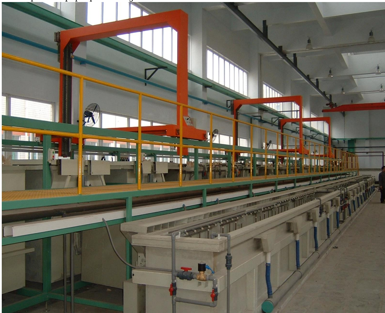
El zinc placas equipo. planta de galvanizado.
