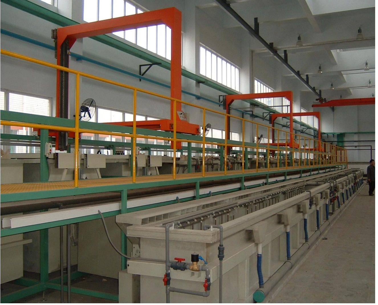
ınko kaplama ekipmanları. ınko kaplama tesisi.
